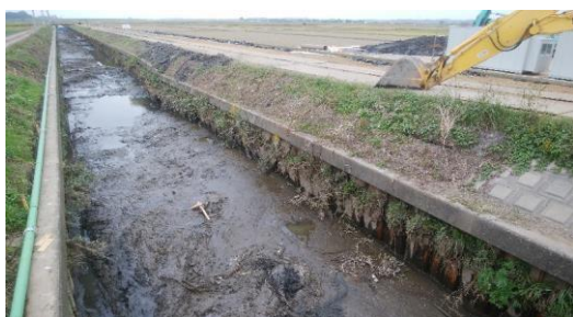
現況:軽量鋼矢板護岸 → 腐食著しい (利根土地改良区内)
