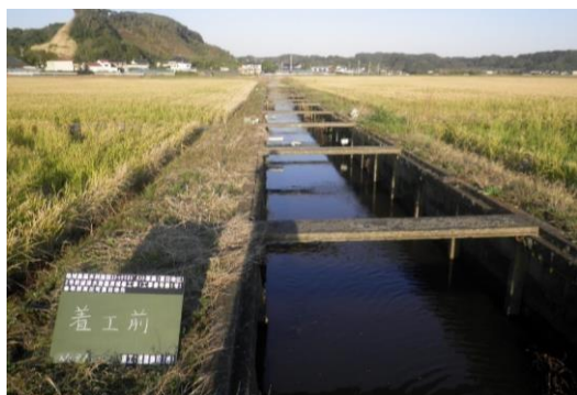
現況:切梁式柵渠 → 耐用年数超過、洗堀、老朽化 (干潟土地改良区:夏目支区地内)
